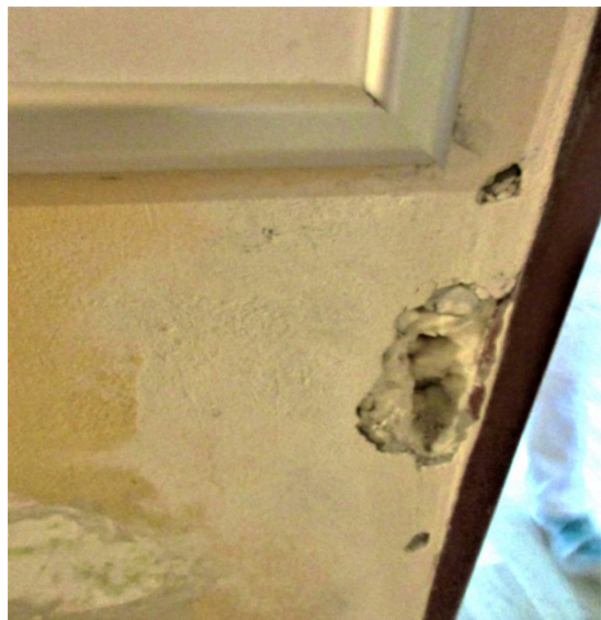
Obrázek 5 - opakovaně opravovaná díra ve zdi
