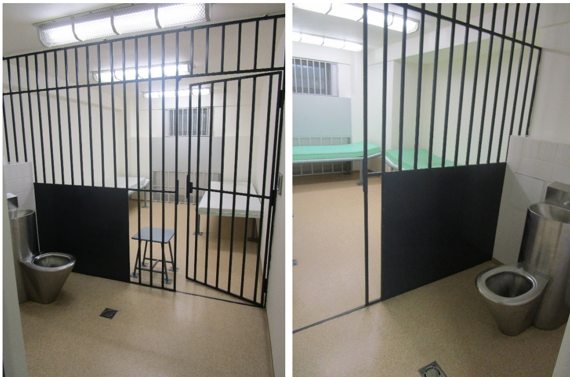
Foto č. 3 a 4: Antivandalové sanitární zařízení v cele č. 1 a cele č. 2 pro dvě osoby bez poklopu a prkénka. Součástí cel je dělicí kovová mříž s celokovovou zástěnou.
