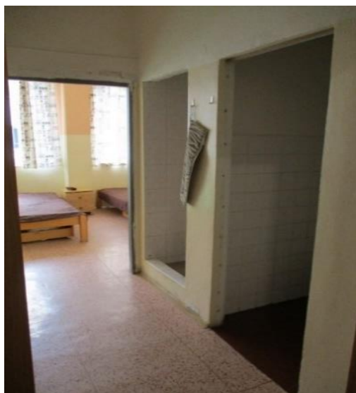
Obrázek 7: Chybějící dveře u pokoje, toalety a sprchy na oddělení B, pohled z chodby
