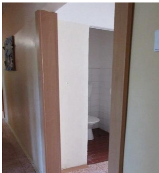
Obrázek 8: Chybějící dveře u toalety na oddělení B, pohled z chodby
