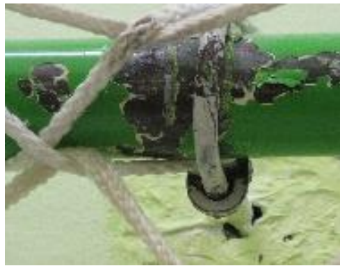
Obrázek 9 – opakovaně opravované ukotvení síťového lůžka do zdi
