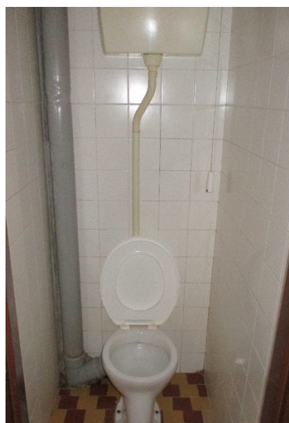
Obrázek 2: WC se šňůrovým splachovadlem
