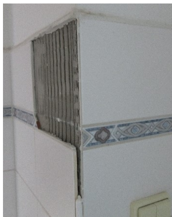
Obrázek 6 - poškozené obklady na stanici 16
