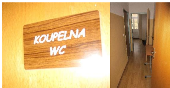
Obr. 3, 4: Neodpovídající označení dveří a chodba s pokojem za nimi
