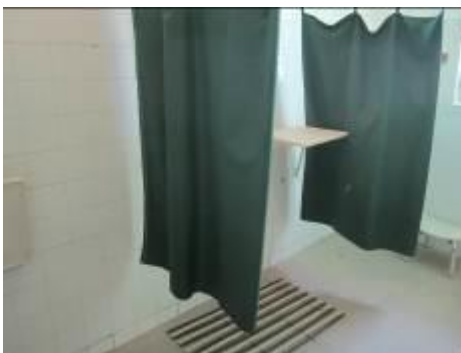
foto 6: chybějící závěs v prvním prostoru pro důkladnou osobní prohlídku a chybějící rošty ve zbývajících dvou prostorech.
