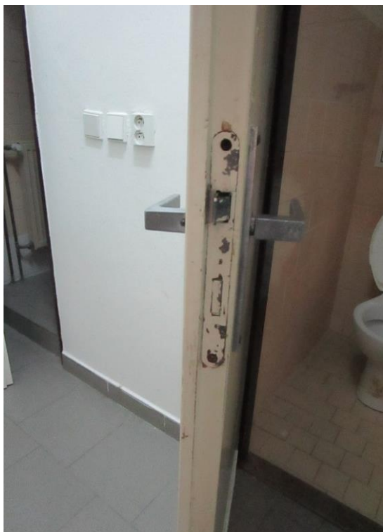
Obrázek 5 – Dveře od WC při následné návštěvě.
