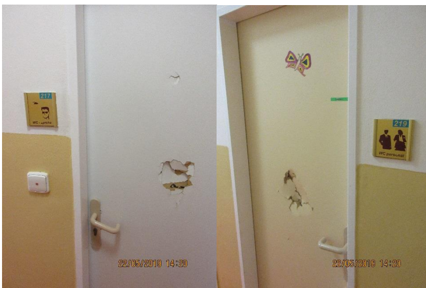
Obrázky č. 11 a 12: Poškození dveří způsobené klienty s problémovým chováním
